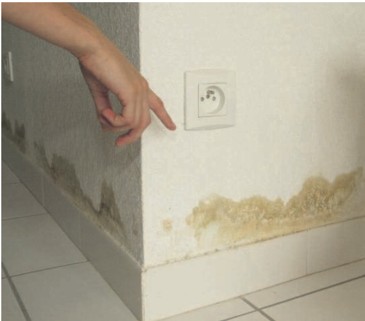
Les moisissures envahissent de plus en plus nos logements, insuffisamment aérés et souvent confinés. Les habitations les plus récentes ne sont pas épargnées par ce phénomène.
